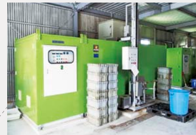
生ゴミ処理機全景(2台あります)
