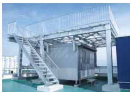
避難設備と防災倉庫
