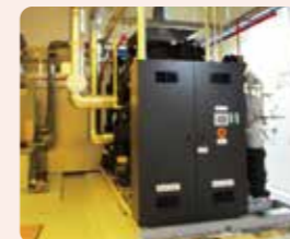
新設されたノンフロン冷凍機
